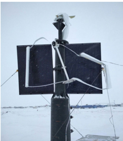
Рис. 2. Деформация ветрогенератора от шквалистого ветра
